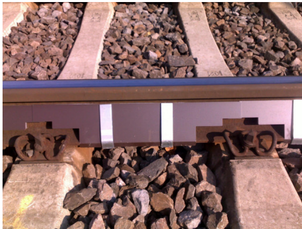
Bild 10: Beispiel einer Schienenstegabschirmung
